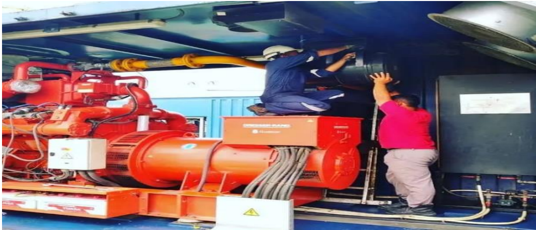
Gambar 10. Pekerja Teknisi Pemeliharaan Mesin Kernel Tidak Menggunakan Alat Pelindung Diri (APD)
